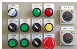
全自動制御盤
